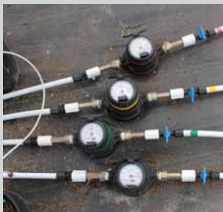
Compteurs d'eau mesurant le volume d'eau utilisé
